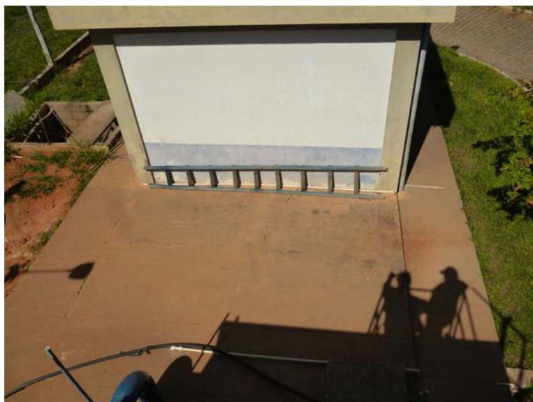
FIGURA 14 – CISTERNA DE CONCRETO ENTERRADA DE ÁGUA TRATADA E SISTEMA DE ADIÇÃO DE CLORO (ETA APERIBÉ) - FONTE: CONSÓRCIO MPB/RPEOTTA (2014)
