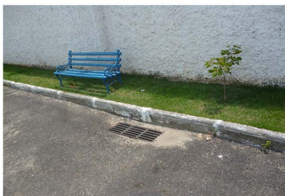
FIGURA 37 – ESTRUTURAS DE MICRODRENAGEM - APERIBÉ
