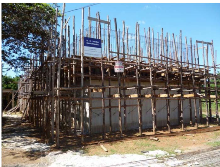
FIGURA 29 – OBRA DA ETE DE APERIBÉ.
